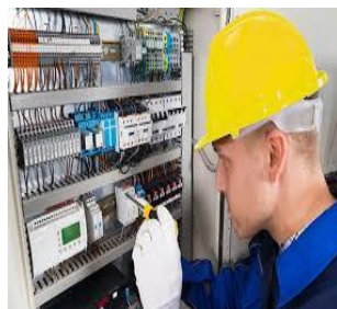
Impianti elettrici di messa a terra DPR 462/2001
