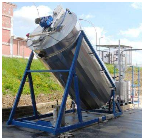
Impianto pilota di digestione anaerobica (6 m 3 ) per test innovativi di produzione biogas
