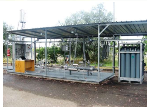
Impianto pilota a membrane per la produzione di biometano da 350 m 3 biogas / h,
