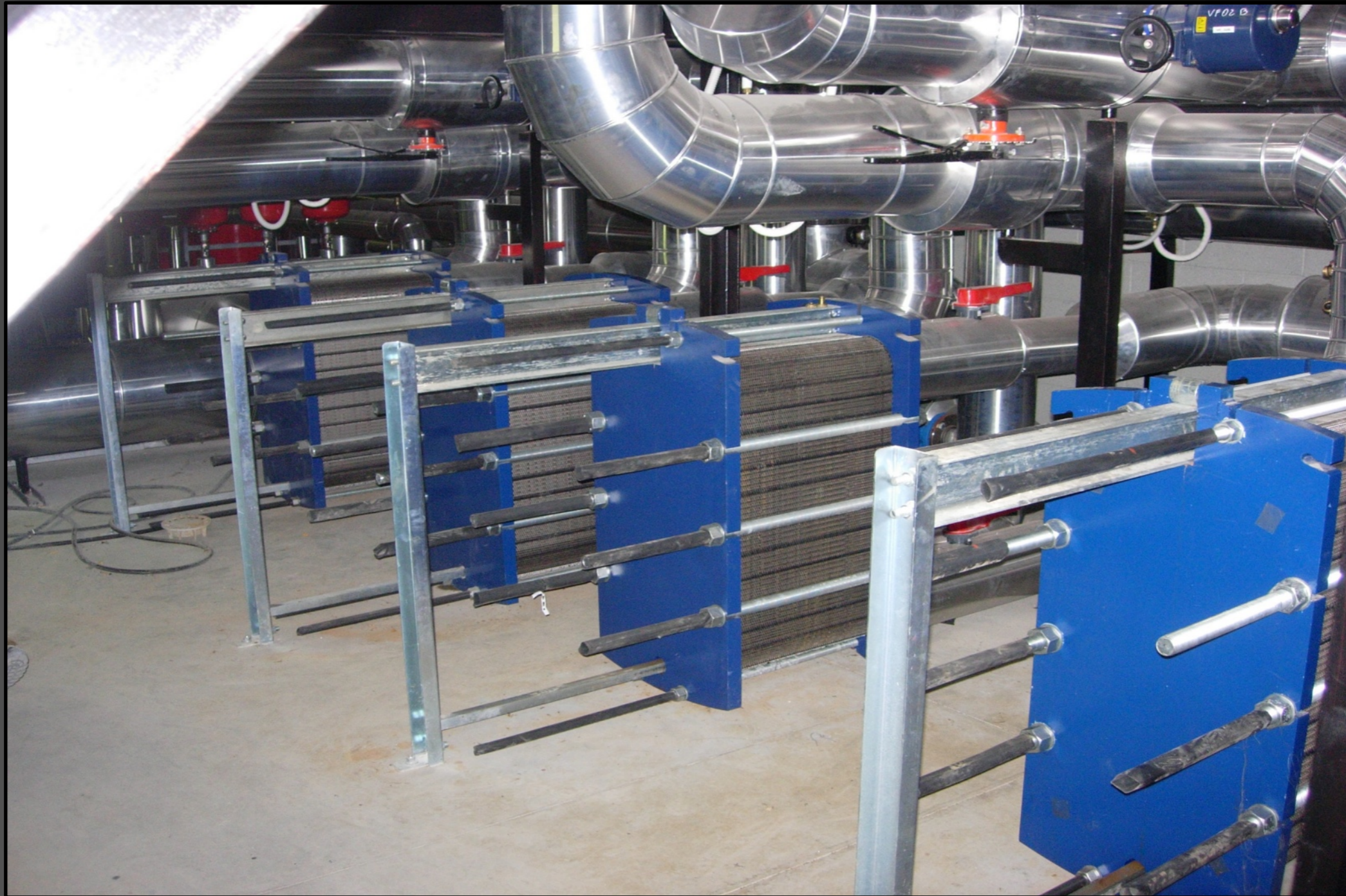
Scambiatori acqua di mare/anello di condensazione
