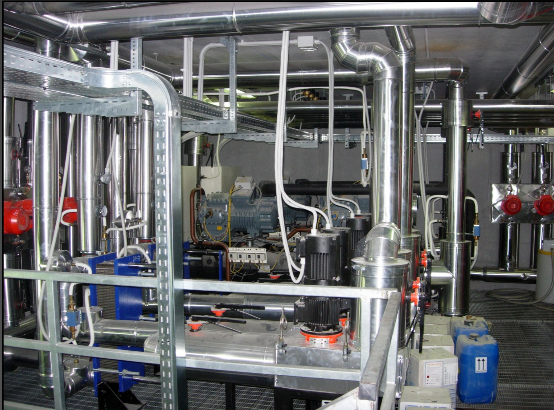
Pompe di calore produzione acqua calda sanitaria
