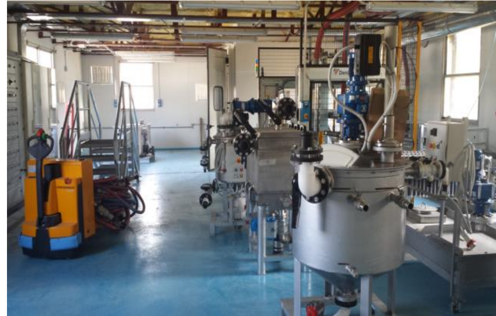
Impianto ROMEO: panoramica
