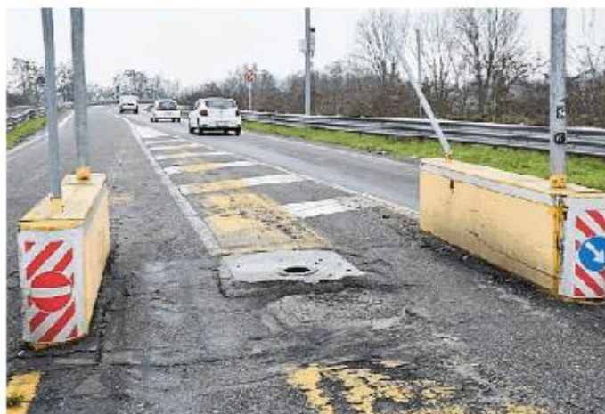
Pilomat guasti: i tir transitano nonostante il cantiere e i ponteggi
