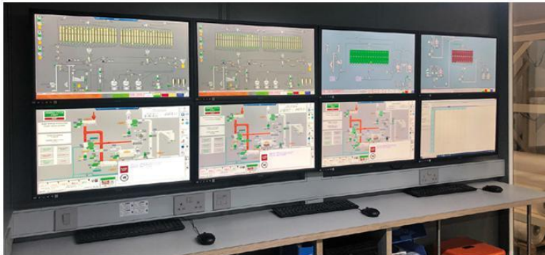
Visualizzazione mediante monitor di un impianto Brambati in funzione.
